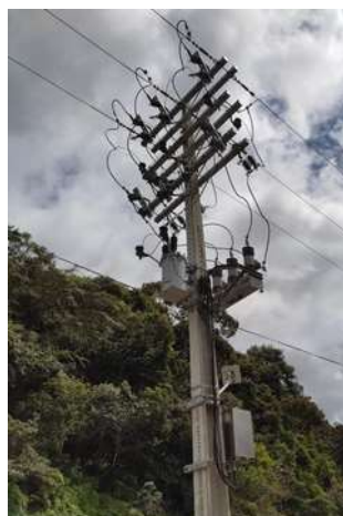
Fig. 2. Religador automático instalado na rede.
