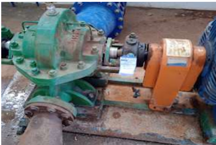
Figura 3: Identificação da Anomalia
