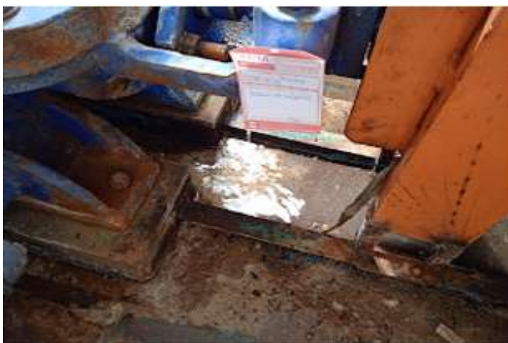
Figura 4: Identificação da Anomalia
