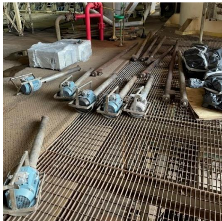
Figura 1 – Bombas de Drenagem Auxiliar
