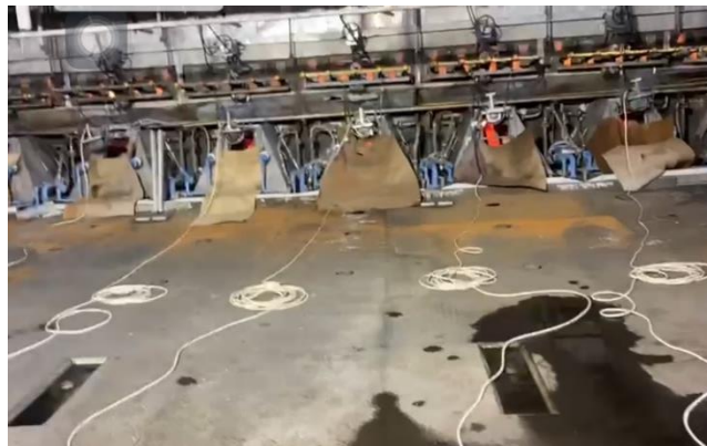
Figura 3 - Bombas Auxiliar em operação
